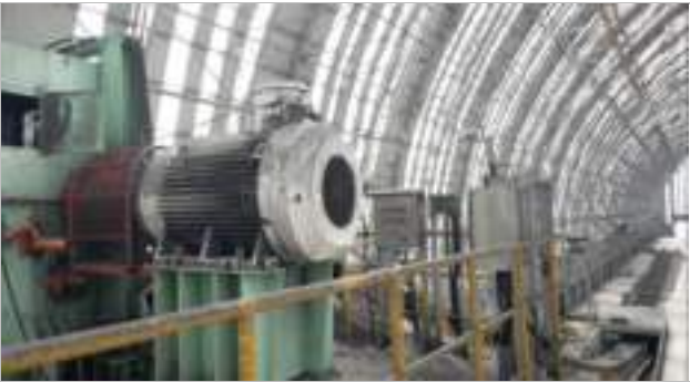
日照港口“散改集”项目 110kW 皮带机永磁电机
