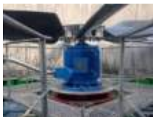
【55kW】冷却塔风机
