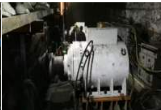
山西同煤某矿井 2×500kW 1140V 伸缩式皮带机
