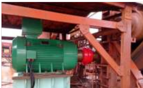
日照港口 250kW 风冷高压皮带机永磁电机
